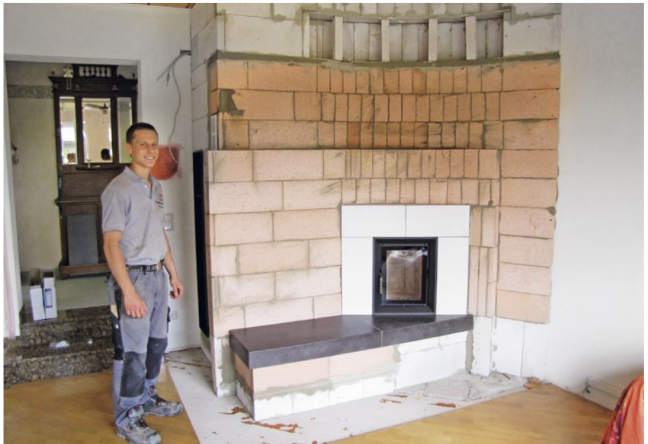
Aufbauarbeit: Der Ofenbauer ist mit dem Aufbau zufrieden und kann seine weiteren Schritte planen.
